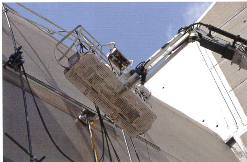
Télécommandé à distance, le robot de désamiantage As Protek est fixé sur un cadre métallique pour le balayage de la surface à traiter.
